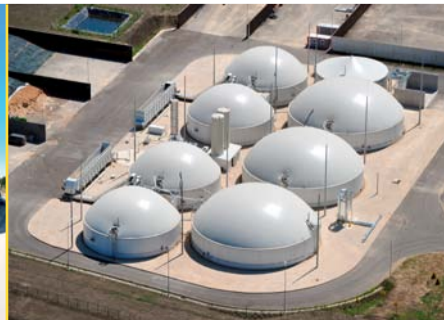
Réservoir et biogaz
